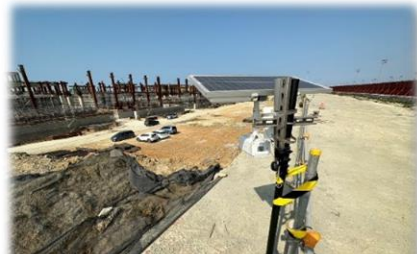
太陽能揚塵監視器IPCAM安裝
