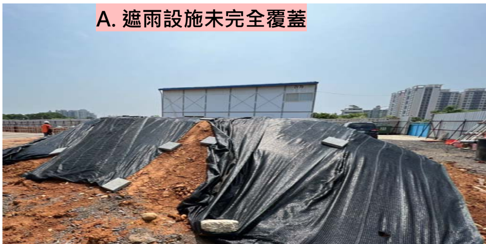
B. 土方裸露未覆蓋遮雨設施
