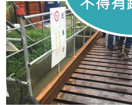
(2)廢水處理設備 (3)告示牌
