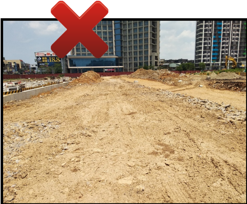
裸露地表未設置防制措施 (缺失記點10點)
