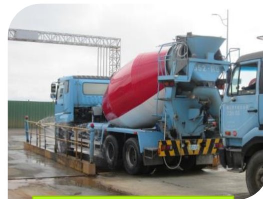
自動沖洗設施
