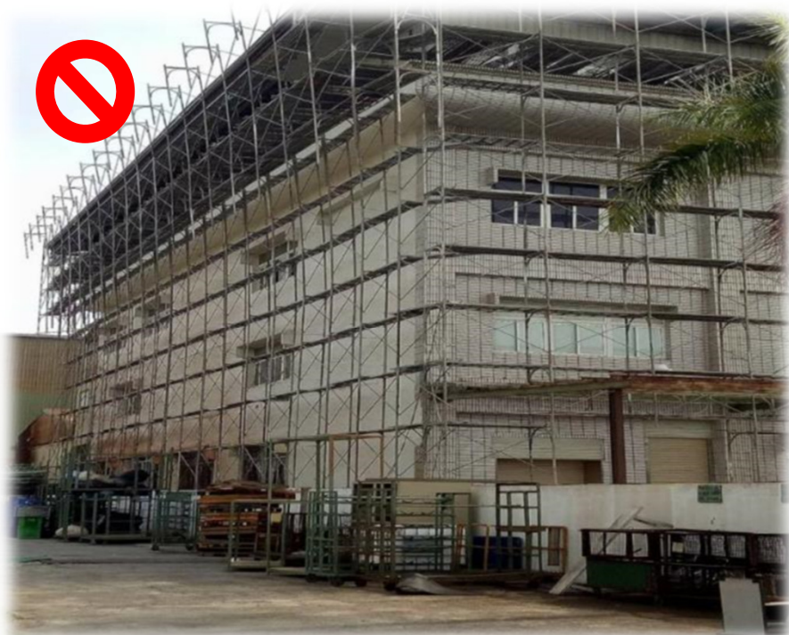
結構體無設置防制設施
