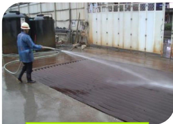
高壓沖洗設備
