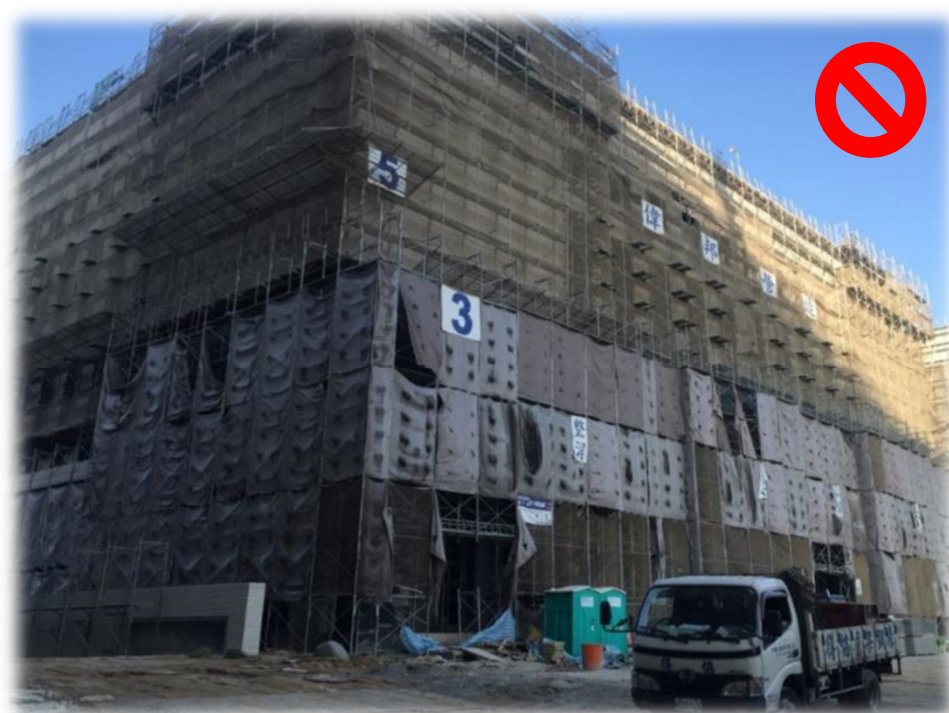
防塵布、防塵網破損
