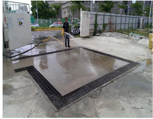
(H) 洗車廢水收集設施 (二)
