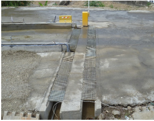
(G) 洗車廢水收集設施 (一)
