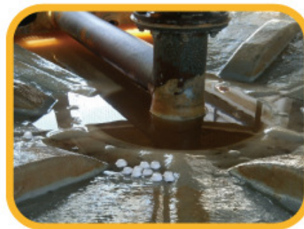
▲ 冷卻水塔投藥情形
