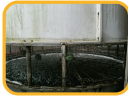
▲ 冷卻水塔未設防護網
