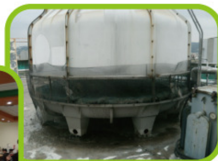
▲ 冷卻水塔應設置完整
