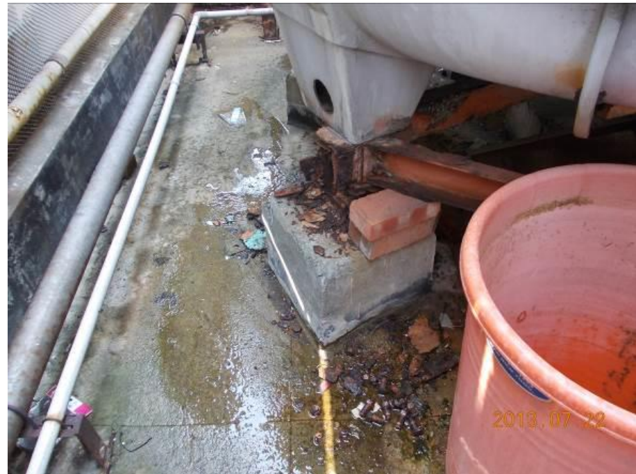
冷卻水塔漏水
