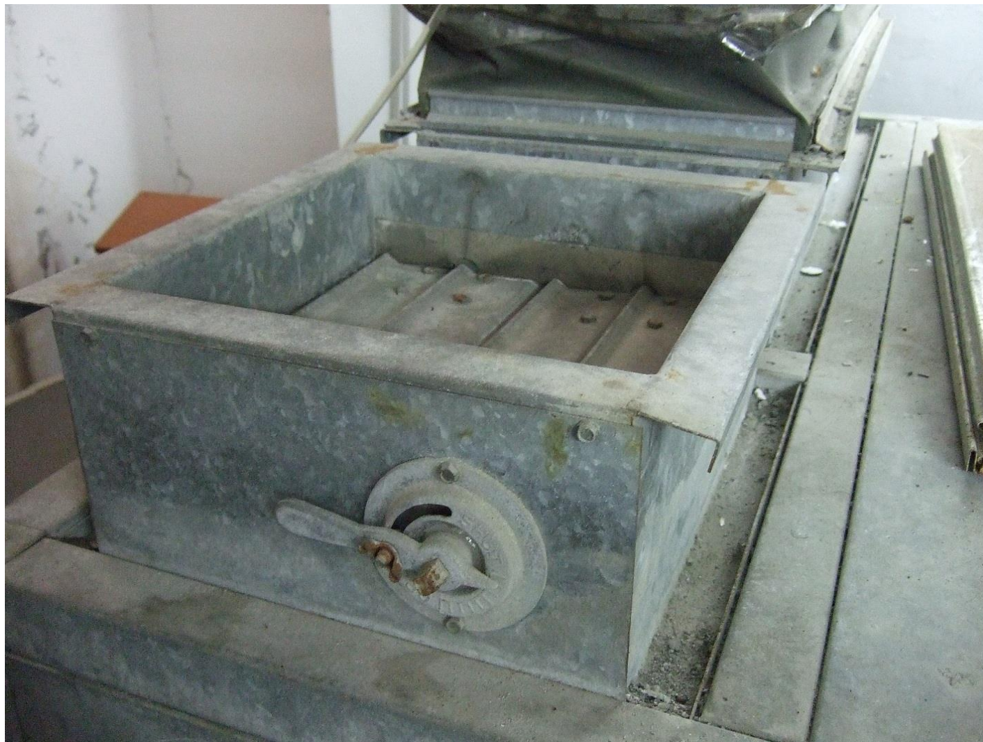
外氣引入口未開啟 室內換氣不足
