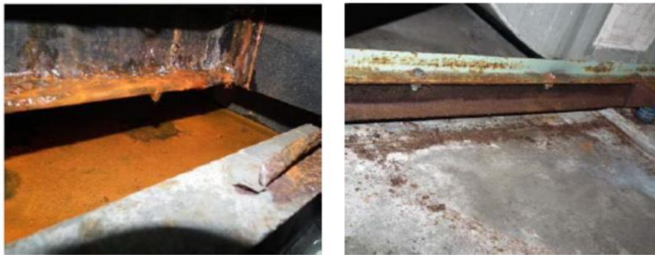
圖 18 空調系統冷卻盤管髒污情形
