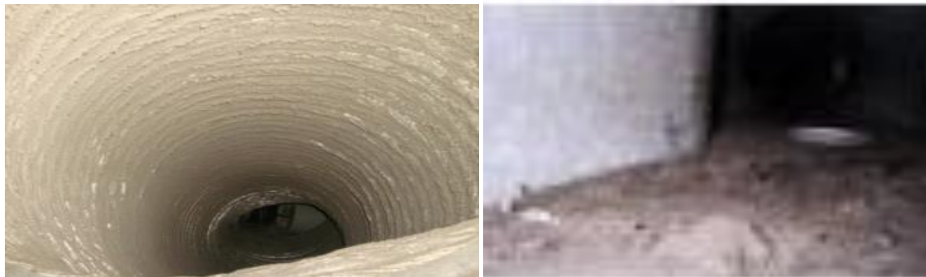
空調風管積塵之情形
