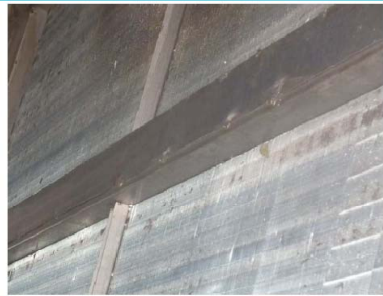
空調系統冷卻盤管髒污情形
