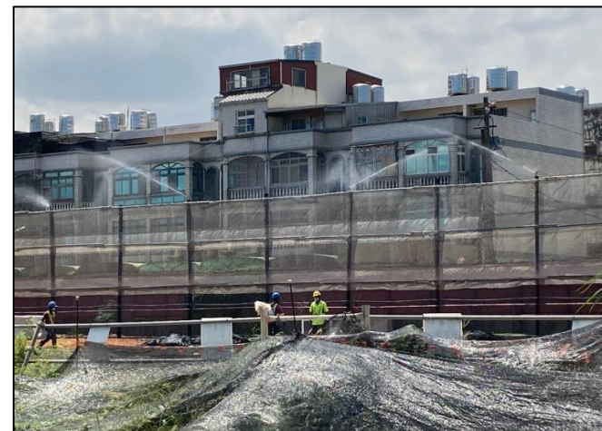
自動灑水設備
