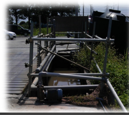
洗車台應設置沈砂池 ，妥善處理廢水
