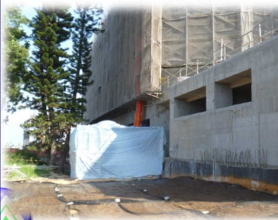
建築物內部管道、電梯孔道
