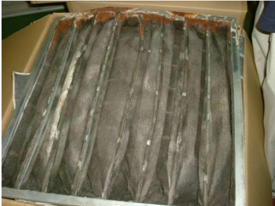
圖 19 空調系統過濾網損壞情形
