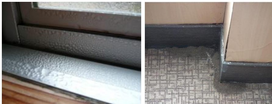
圖 13 窗台冷凝問題及木質裝潢蛀蝕情形
