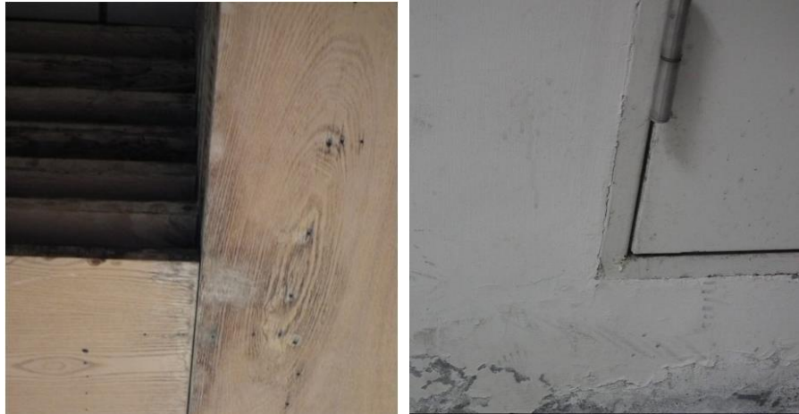
圖 14 室內建材孳生黴菌及牆面壁癌
