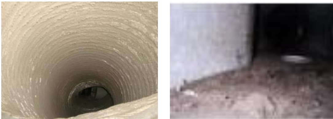
圖 41 空調風管積塵之情形
