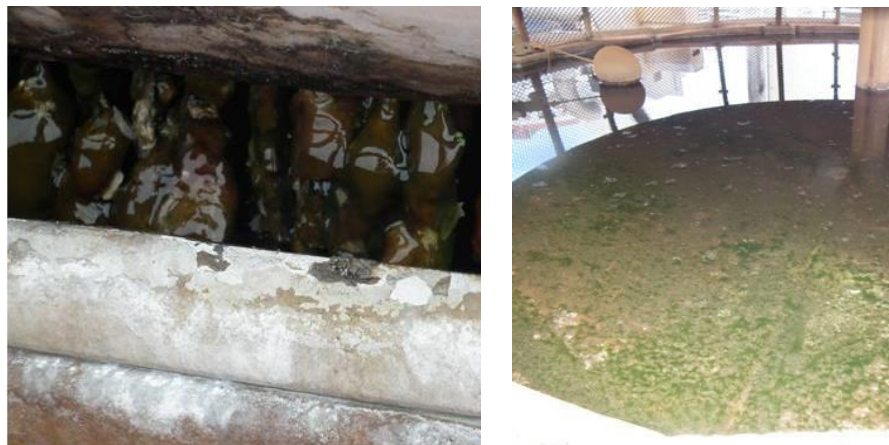
圖 24 冷卻水塔之貯水池內藻類孳生情形
