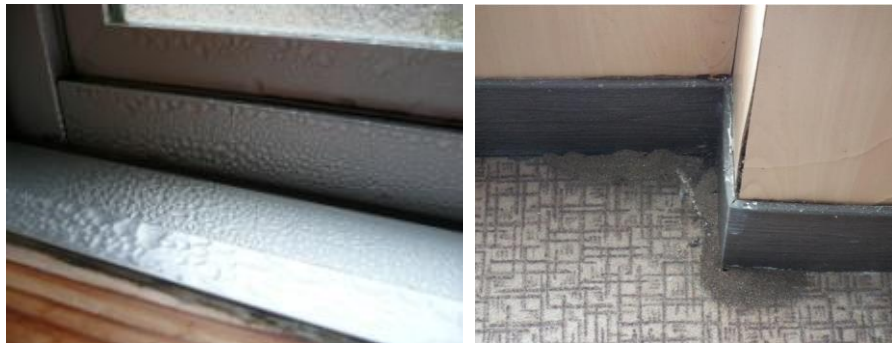
圖 13 窗台冷凝問題及木質裝潢蛀蝕情形
