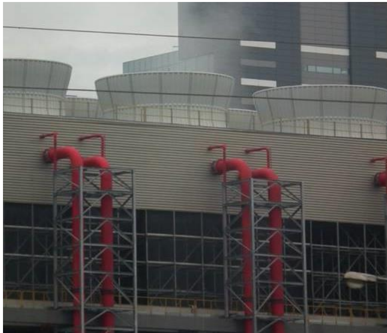
圖 25 冷卻水塔產生水霧情形
