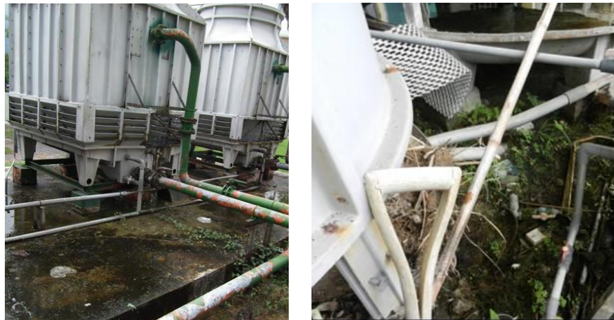
圖 27 冷卻水塔周圍環境維護不佳情形
