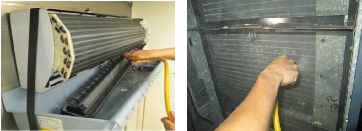
圖 35 空調室內側熱交換器清潔與維護
