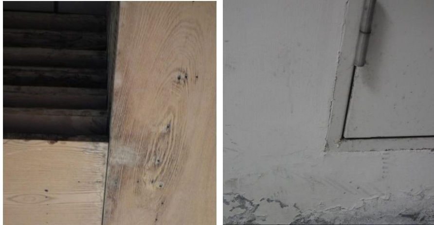
圖 14 室內建材孳生黴菌及牆面壁癌
