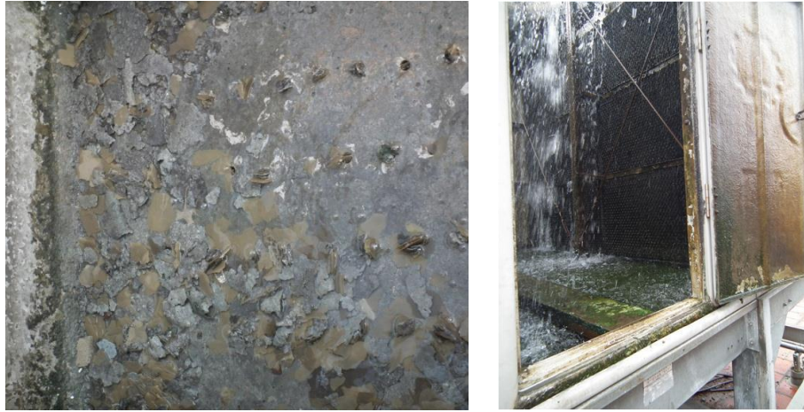
圖 23 冷卻水塔分散水盤阻塞及冷卻水溢流
