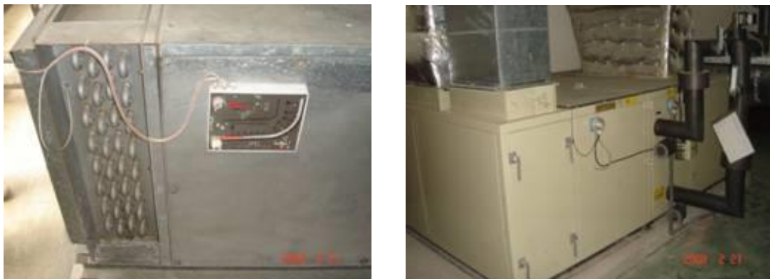
圖 38 過濾網壓差感知裝置的檢修與維護
