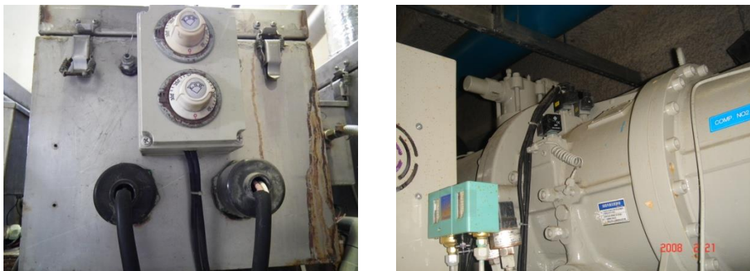
圖 40 設施保護或電力防護裝置之檢修與維護
