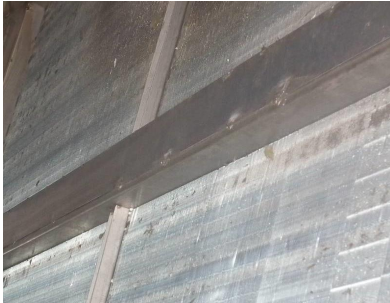
圖 17 空調系統冷卻盤管髒污情形
