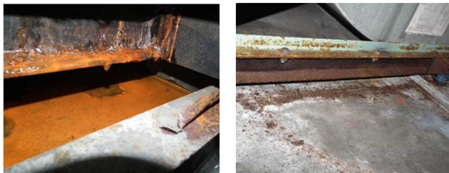
圖 18 空調系統冷卻盤管髒污情形
