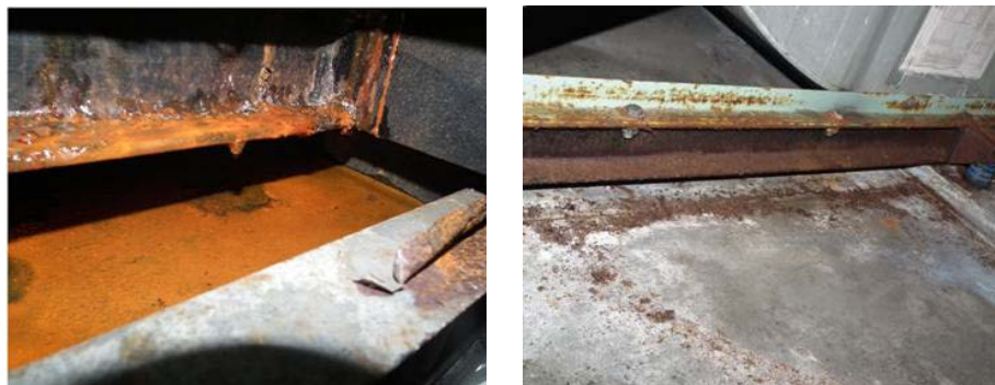
圖 18 空調系統冷卻盤管髒污情形
