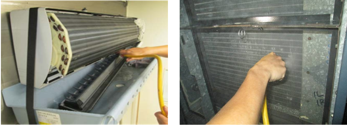
圖 35 空調室內側熱交換器清潔與維護
