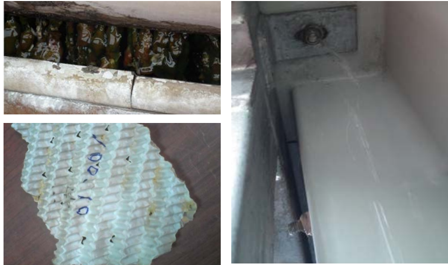
圖 26 冷卻水塔附著髒污及漏水情形
