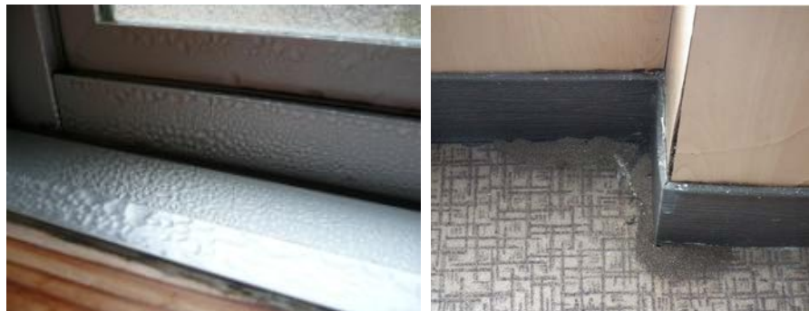
圖 13 窗台冷凝問題及木質裝潢蛀蝕情形
