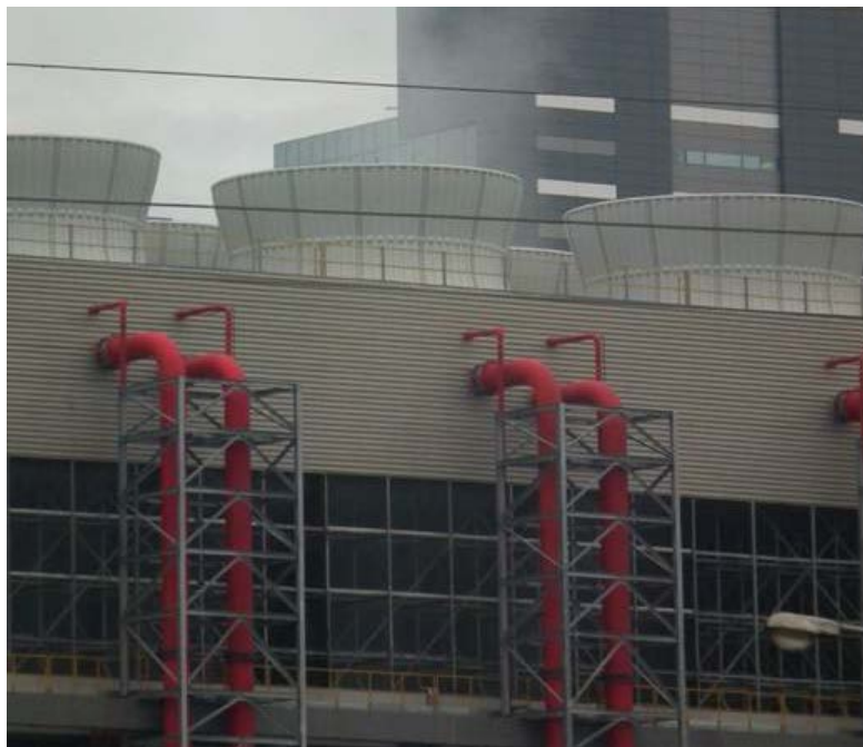
圖 25 冷卻水塔產生水霧情形
