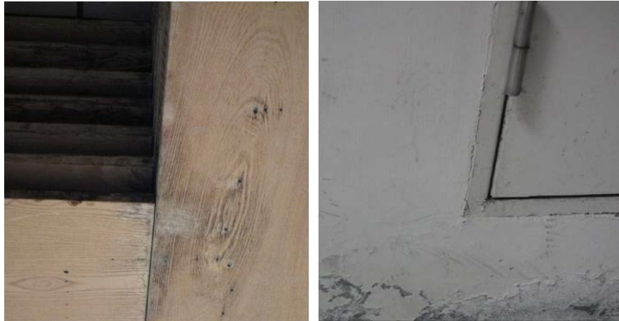
圖 14 室內建材孳生黴菌及牆面壁癌
