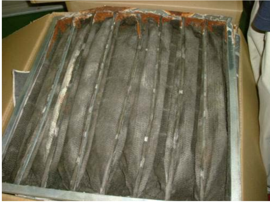
圖 19 空調系統過濾網損壞情形
