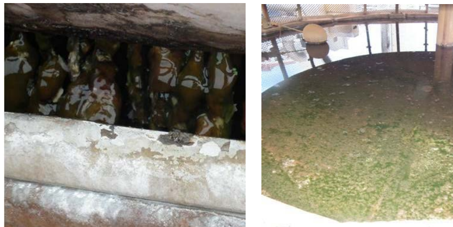
圖 24 冷卻水塔之貯水池內藻類孳生情形
