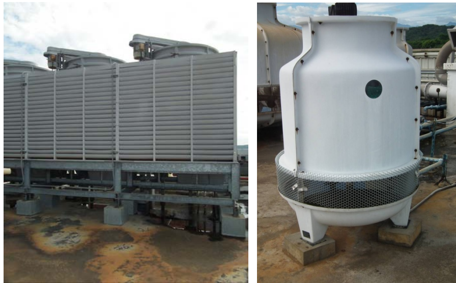
圖 22 常見冷卻水塔結構體外觀
