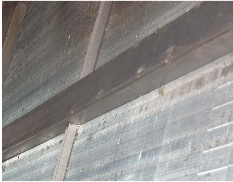
圖 17 空調系統冷卻盤管髒污情形
