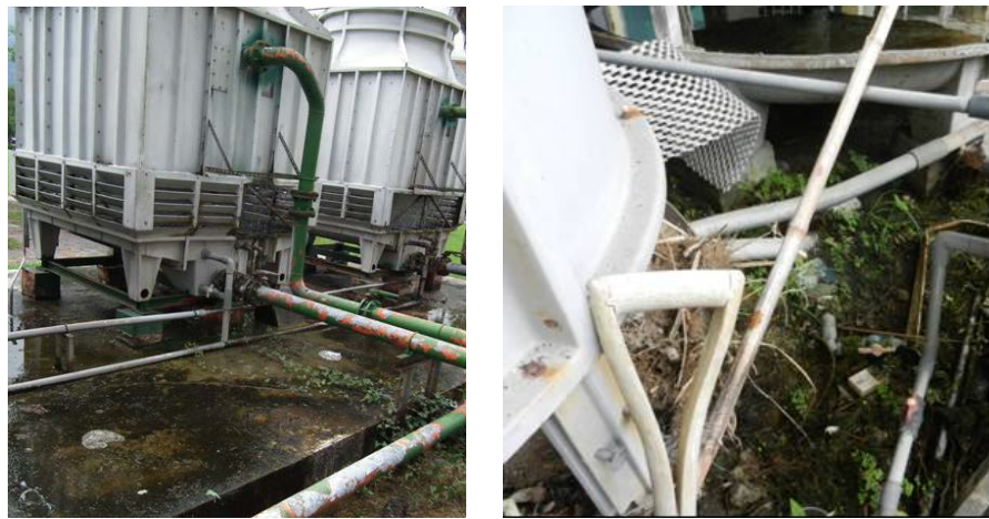
圖 27 冷卻水塔周圍環境維護不佳情形
